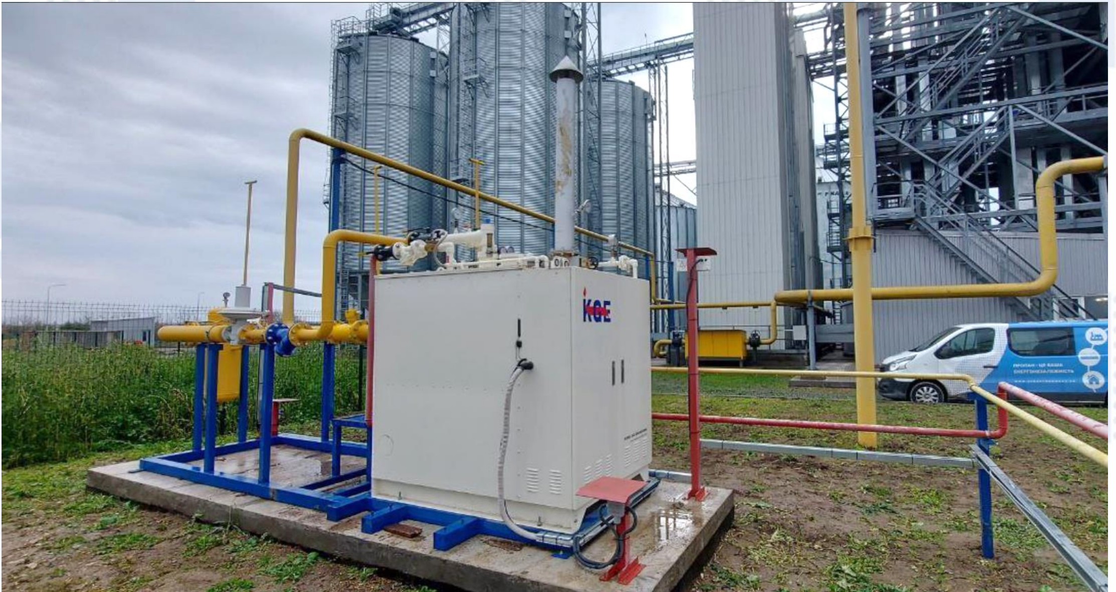
Газопостачання маслоекстракційного заводу 20 Мвт – автономний випаровувач
