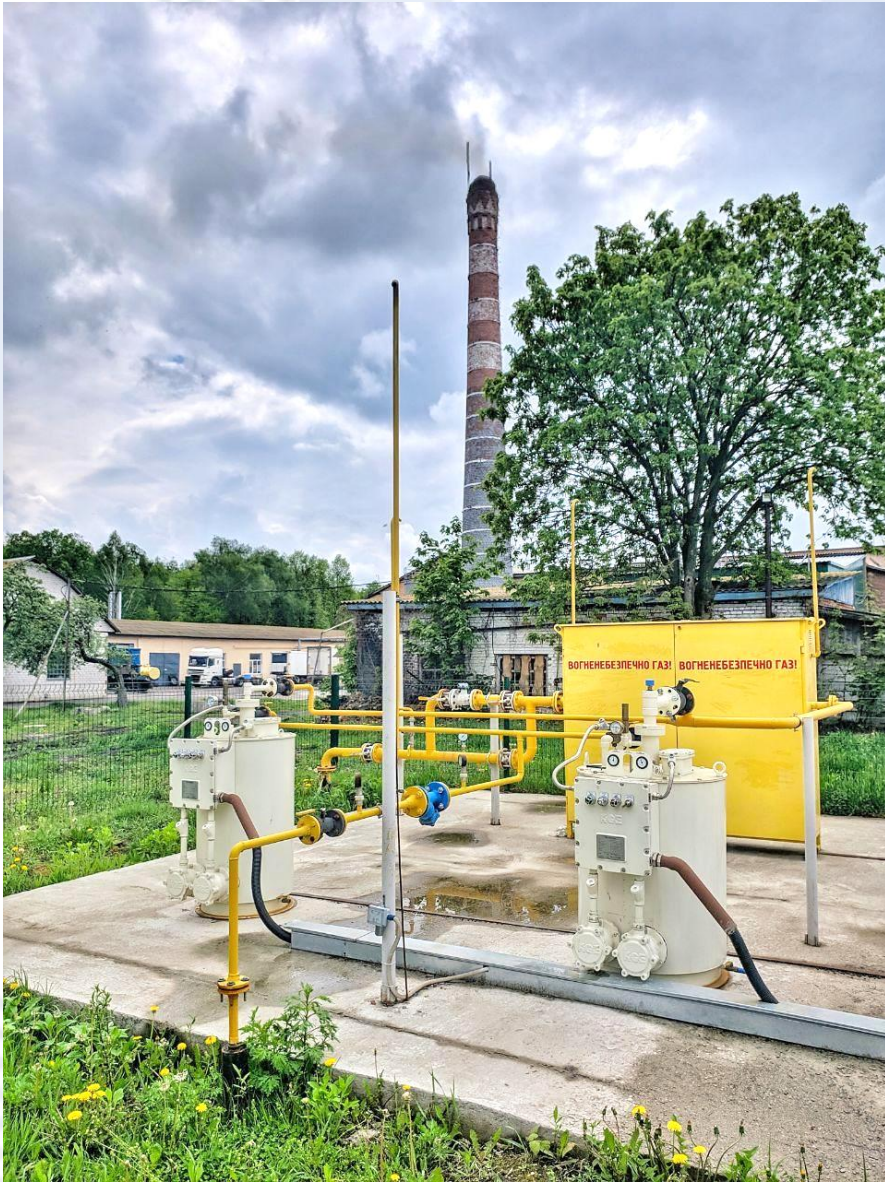
Газопостачання молокозаводу 8 Мвт
