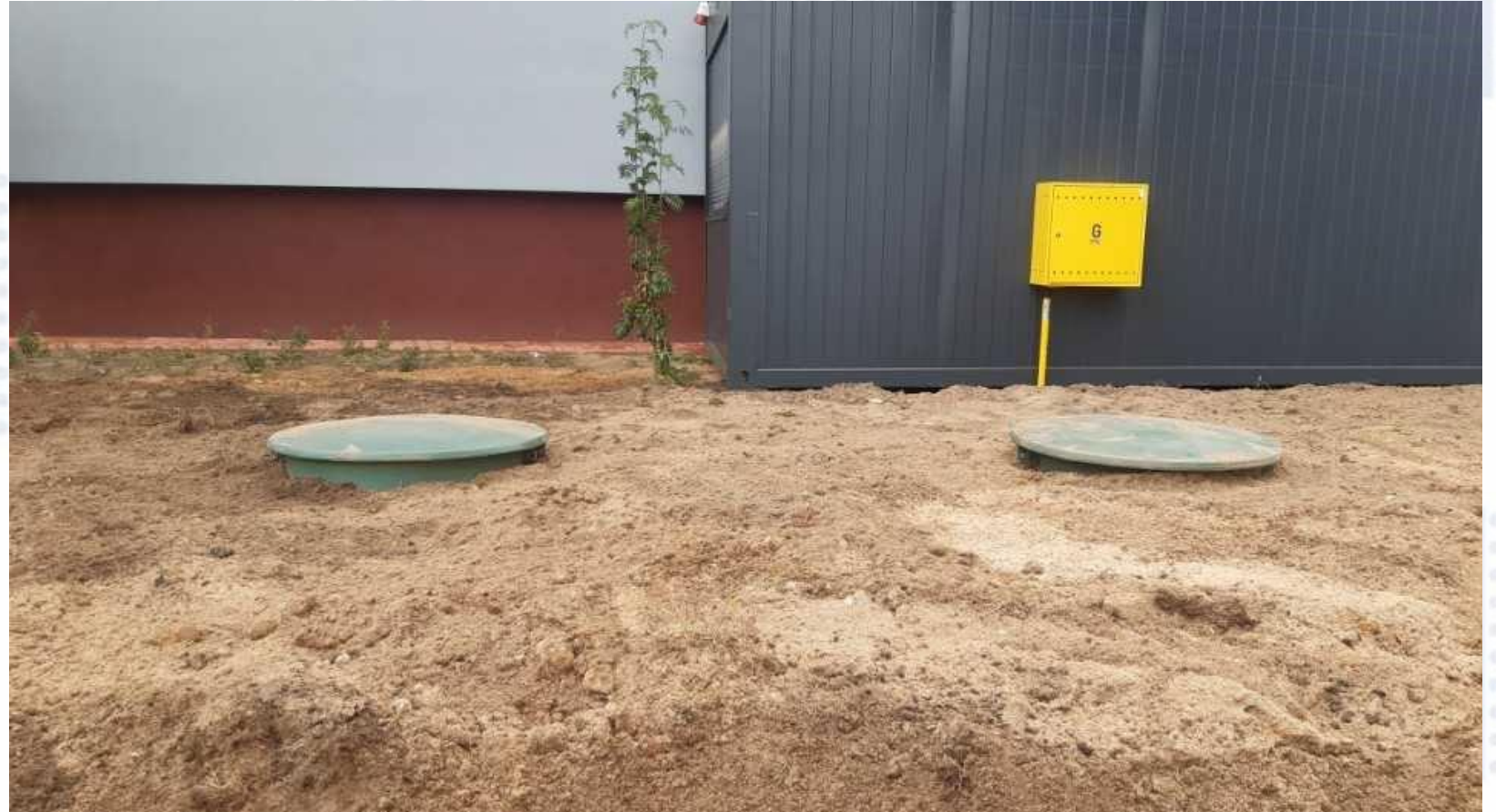
Підземні резервуари LPG в кількості 2 шт
