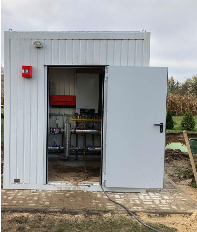
Зовнішня модульна котельня
